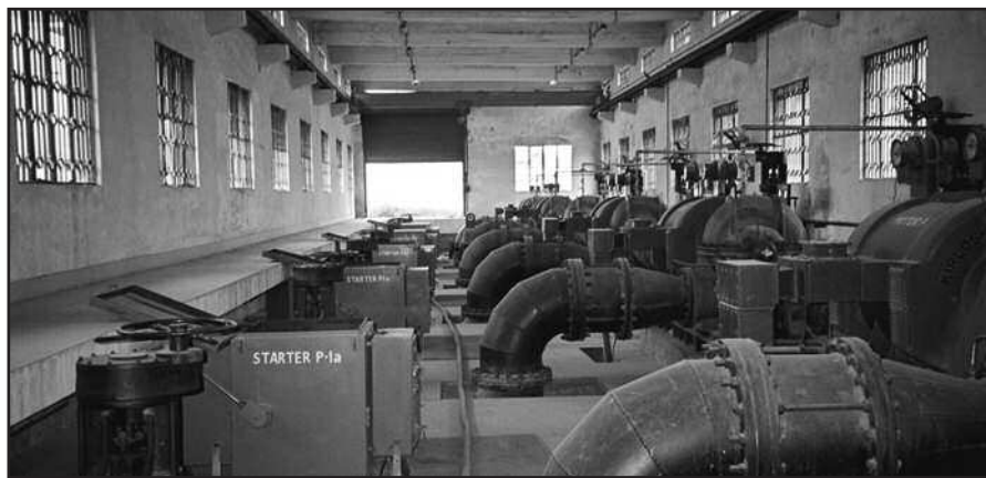
Station d'épuration d'Okhla, Delhi.
