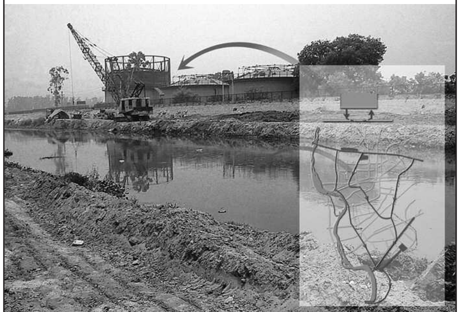
Le canal collecteur n°1 passe devant la station d'épuration de Yamuna Vihar.
